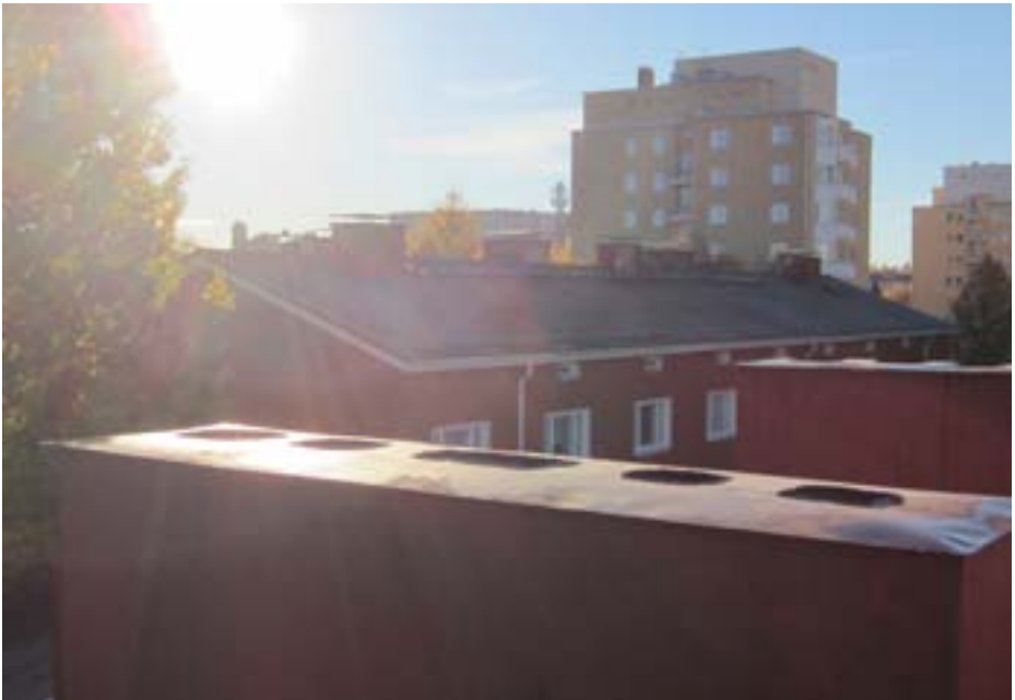
Kuva 7. Kerrostalon piippua. Yksi hormeista on savukanava ja muut poistoilmaa varten. Kuva: Ketola
