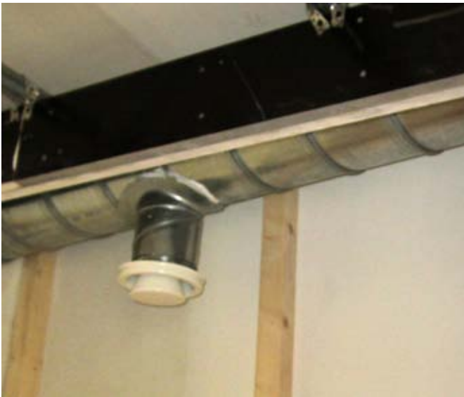
Kuva 9. Koneellisen ilmanvaihdon poistovennttiili. Kuva: Ketola
