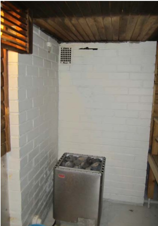
Kuva 15. Kerrostalon sauna painovoimaisen ilmanvaihdon rakennuksessa. Saunaan on myöhemmin vaihdettu sähkökiuas. Kuva: Ketola
