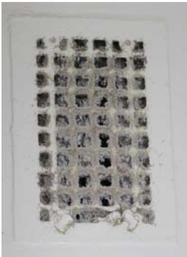
Kuva 11. Painovoimaisen ilmanvaihdon keittiösäleikkö, joka on lähes tukkeutunut rasvasta ja pölystä. Kuvasta voi nähdä, että remonttien yhteydessä säleikön kiinnitysruuvit on peitetty maalilla ja käyttöketju hukattu. Kuva: Ketola
