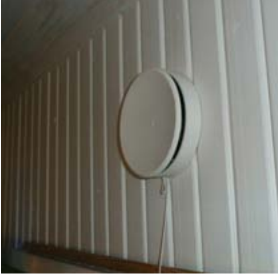
Kuva 13. Pientalon seinään saneerauksen yhteydessä lisätty ääntä vaimentava korvausilmaventtiili. Kuva: Ketola
