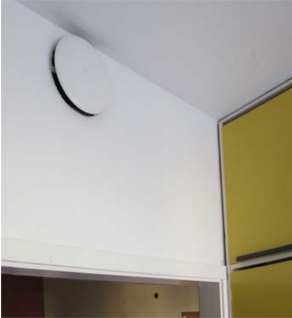
Kuva 4. Keittiön yleis- poistoventtiili. Kuva: Ketola
